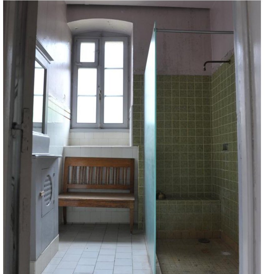
Une douche désaffectée pour cause d'infiltrations.
